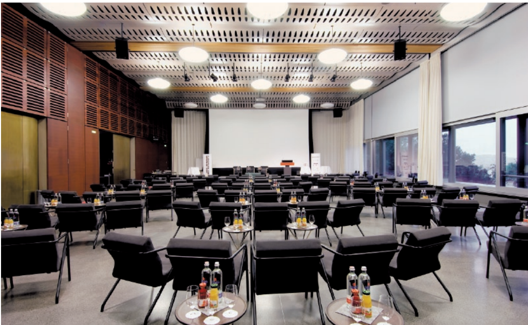
Die bestehende Lüftungsanlage konnte im exklusiv gestalteten Tagungs- und Schulungsraum von Swiss-Re aus architektonischen Gründen nicht umgebaut werden. Leitfähige Luft wurde in die Luftauslässe eingesetzt.
